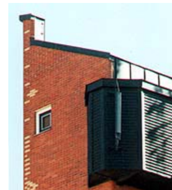
Svart antenn på svart plåt
